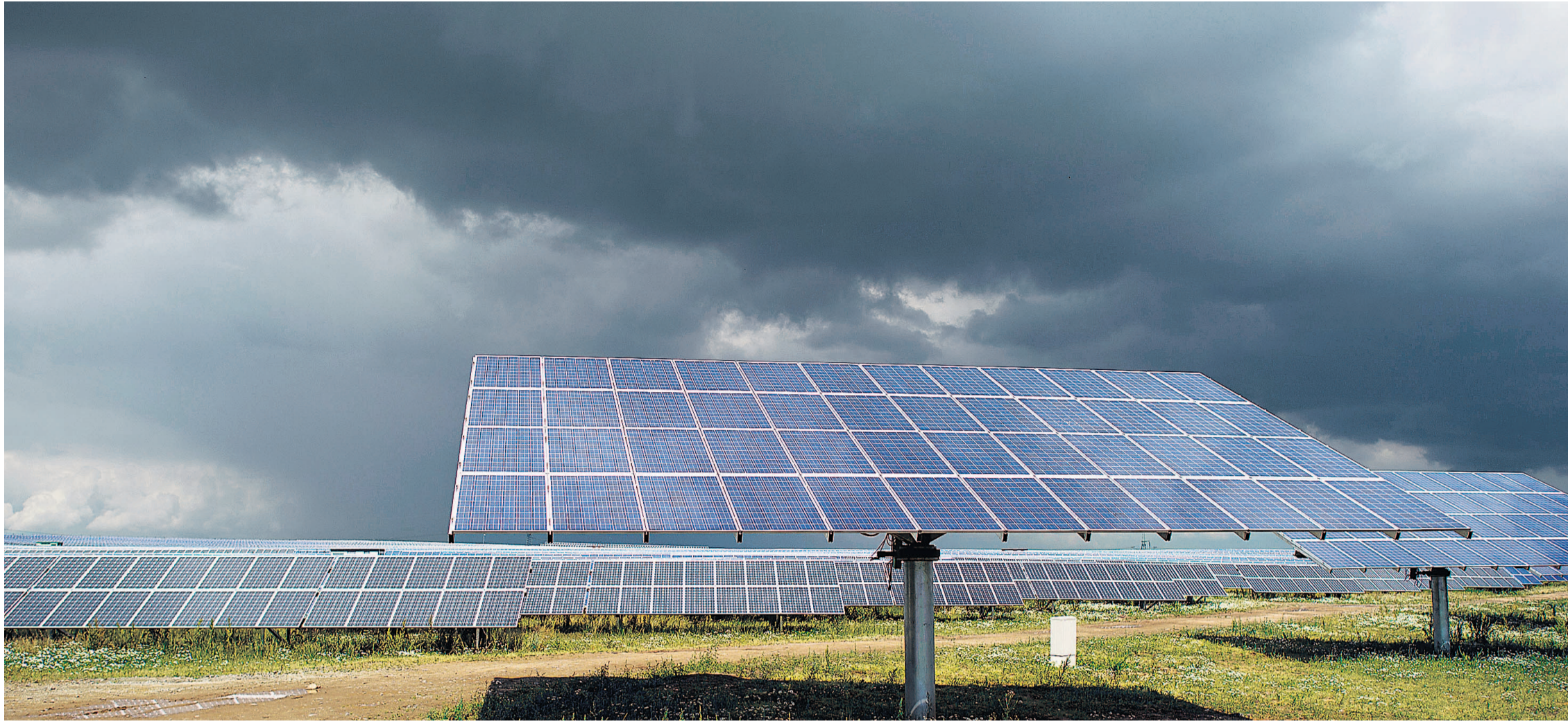
Un erwartet schnelles Wachstum: In den vergangenen beiden Jahren wurden in Deutschland Solarstromanlagen mit einer Leistung von 15.000 Gigawatt neu installiert.
