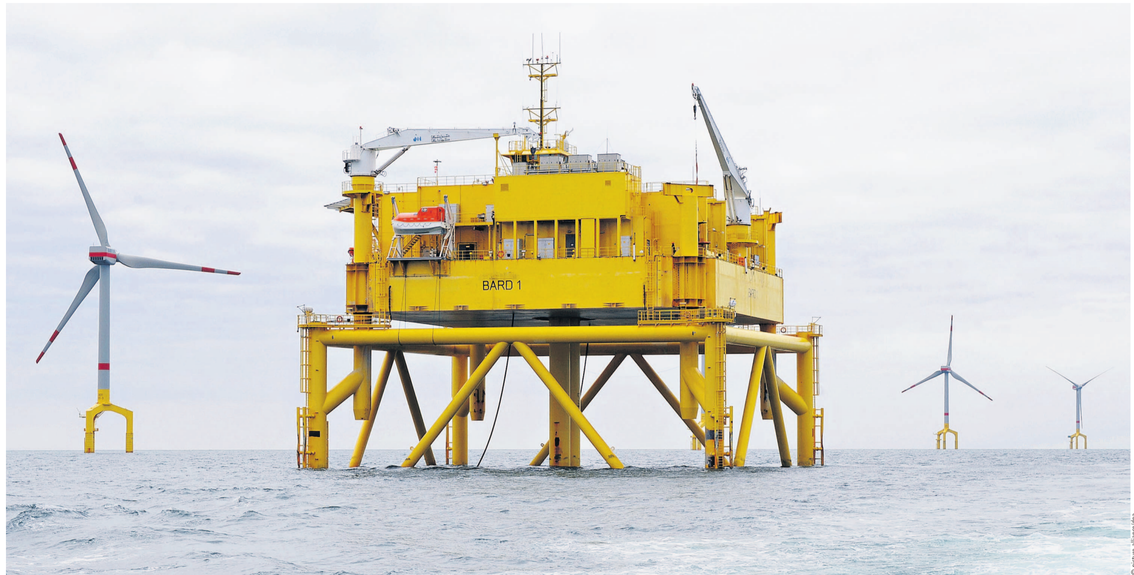
Zu den Windparks auf See gehören auch Wartungs- und Transformatorgebäude. Um das Risiko für die Betreiber nicht zu hoch werden zu lassen, werden die Stromverbraucher am Unternehmerrisiko beteiligt.
