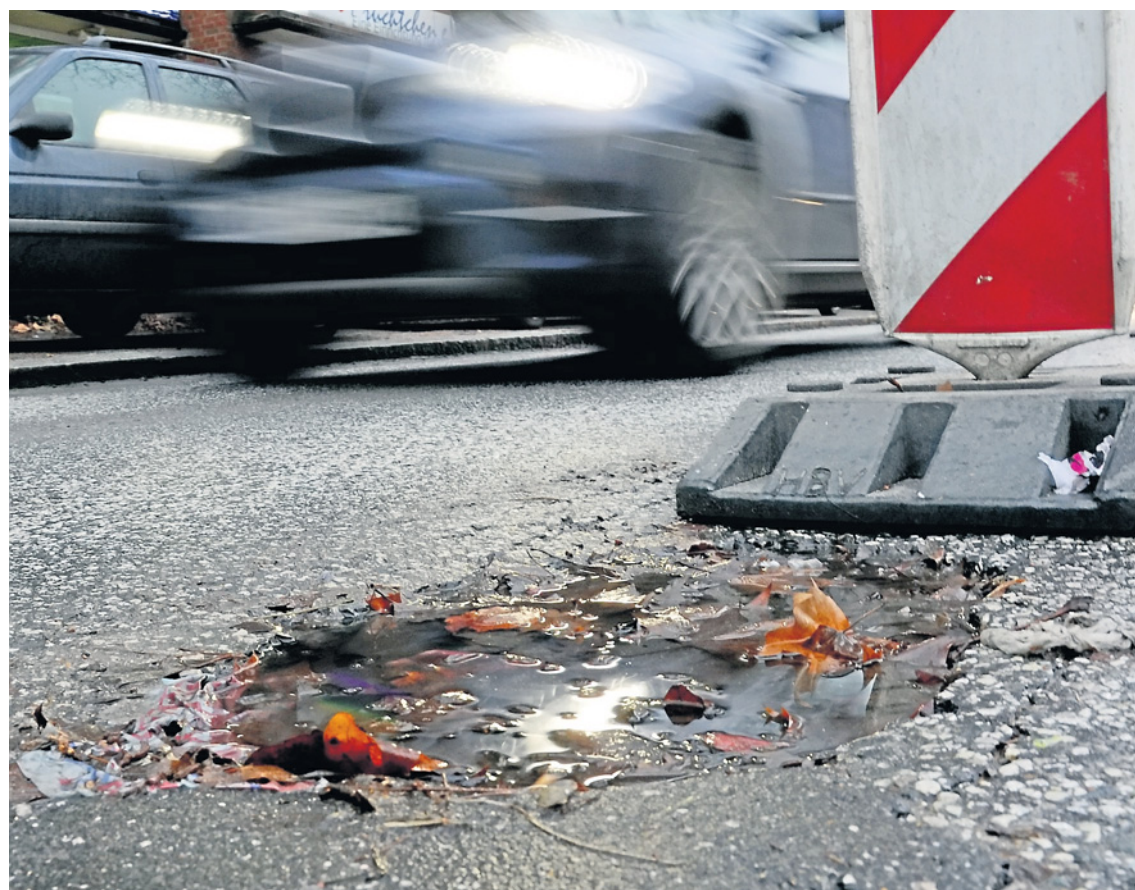
Viele kommunale Straßen sind voller Schlaglöcher und in einem insgesamt schlechten Zustand.
