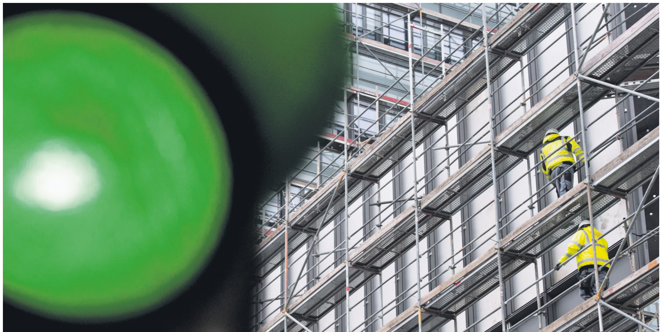
In der Wirtschaft läuft es rund. Auch der Haus- und Wohnungsbau hat derzeit in Deutschland Konjunktur.
