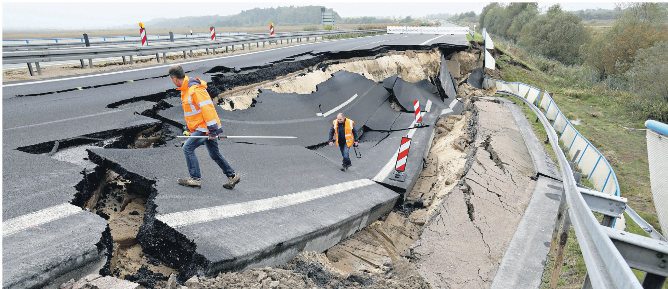
Noch immer wird nach der Ursache für das Absacken der Fahrbahn auf der A20 nahe Tribsees (Mecklenburg-Vorpommern) gesucht. Vermutet werden Fehler beim Gründungsverfahren im dortigen Moorgebiet.
