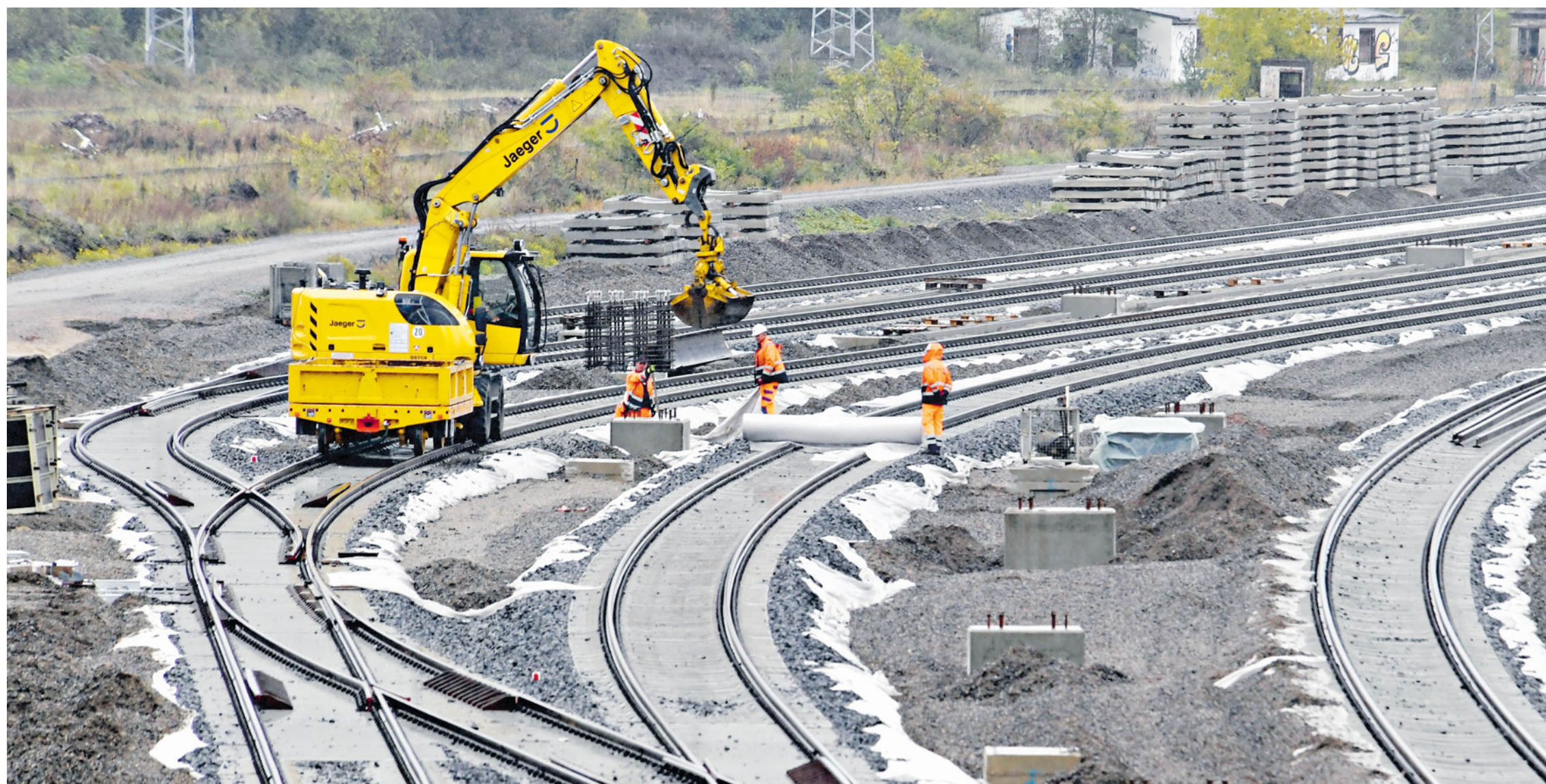
Gleisbauarbeiten in Roßlau in Sachsen-Anhalt: Der Bund will in den kommenden Jahren mehr in die Schienenwege investieren.
