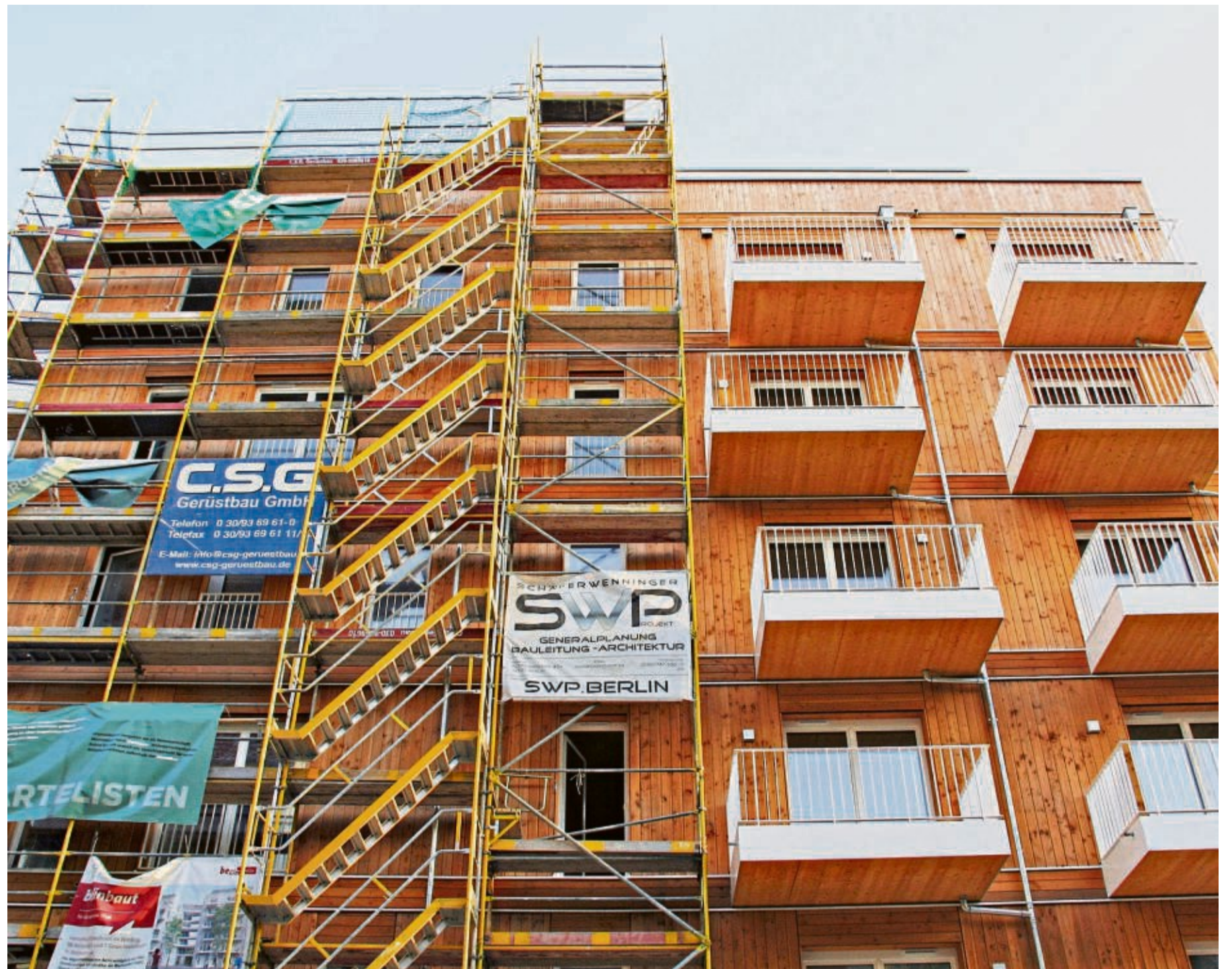
In diesem mehrgeschossigen Bau aus Holz entstehen im Berliner Stadtteil Wedding derzeit 98 Wohnungen, von denen die Hälfte Sozialwohnungen sind. Bislang sind solche nachhaltigen Neubauprojekte die Ausnahme. Die Mehrzahl setzt weiter auf traditionelle Baustoffe wie Beton und Zement.
