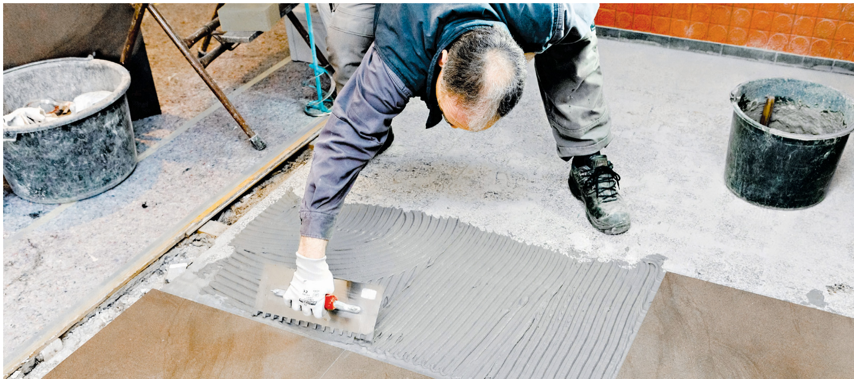
Ein Meister bei der Arbeit: Fliesen für eine zukünftige Küche werden gelegt.
