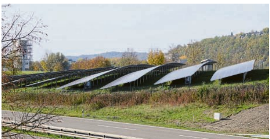
Sollen künftig die Regel sein: Photovoltaik-Anlagen an Autobahnen.
