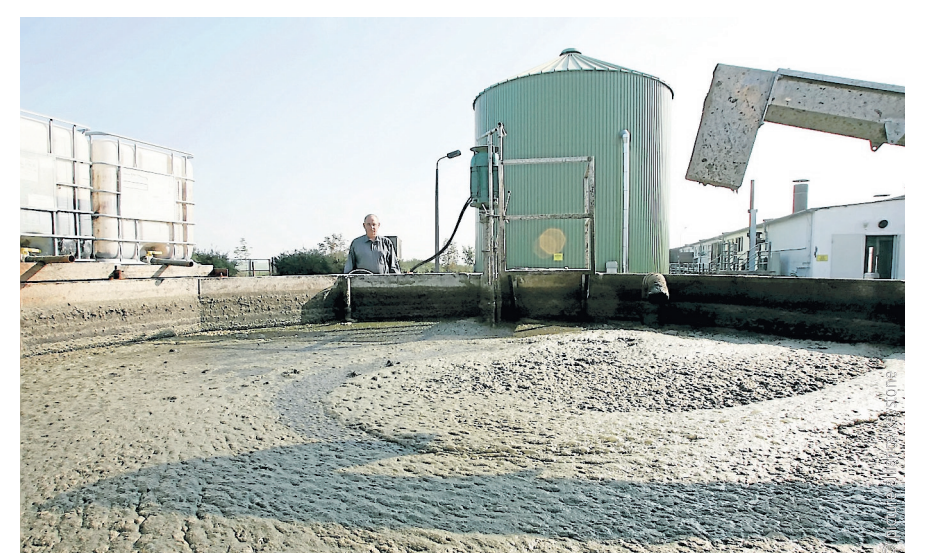
Biogasanlage in Wittstock. Der Güllebonus lohnte sich in Regionen mit viel Viehhaltung.
