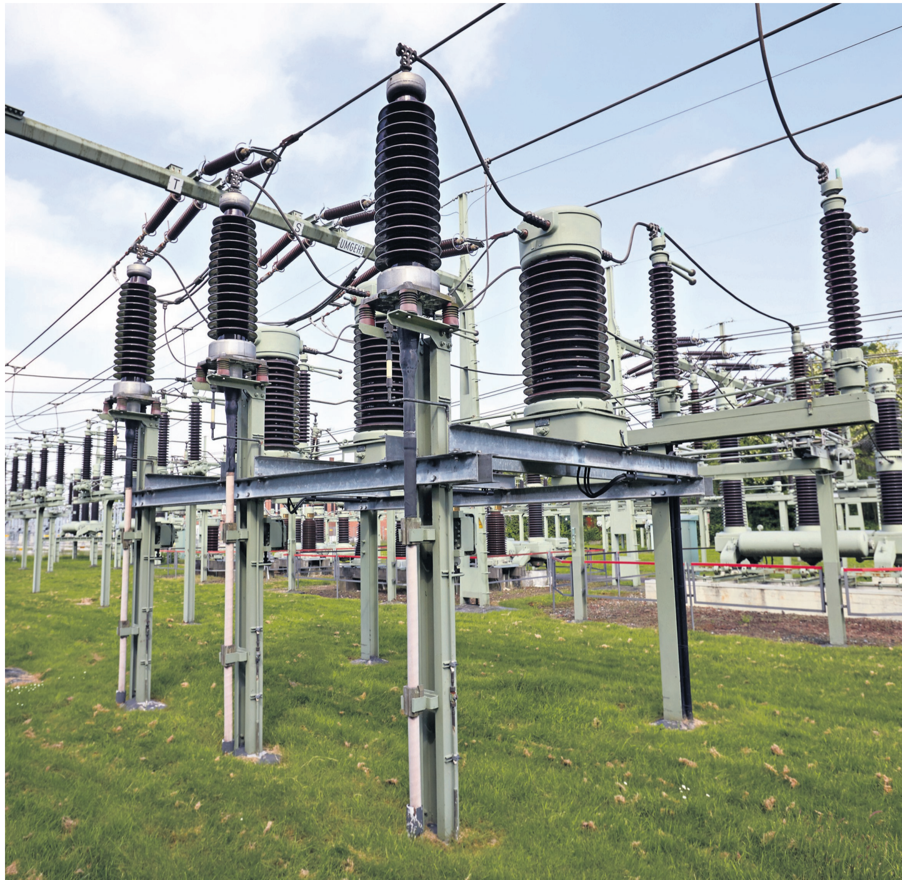
Auch Umspannungsanlagen sollen wieder in kommunale Hände übergehen können.
