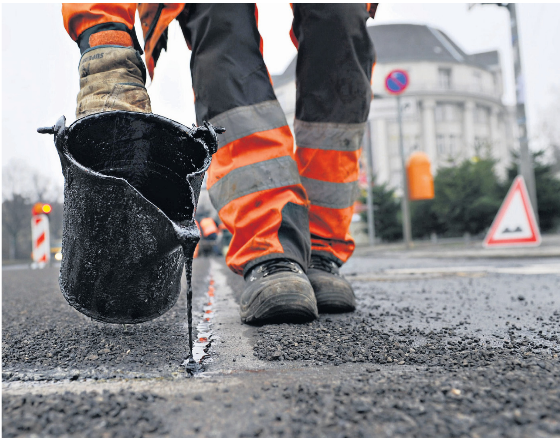
Die Straßensanierung wie hier in Berlin ist eine ständige Aufgabe. Viele Kommunen behelfen sich aus Geldmangel mit provisorischen Ausbesserungen.
