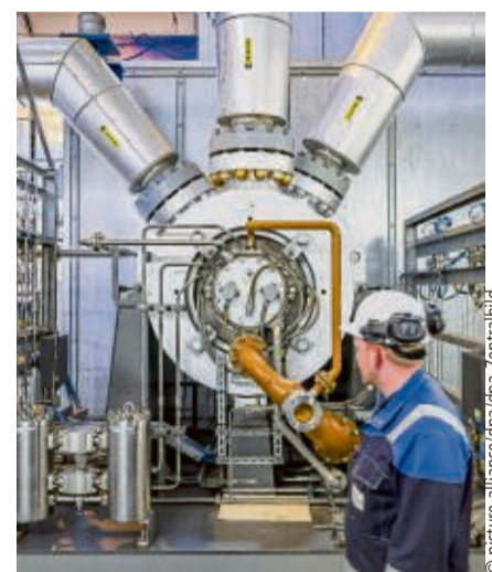
Ein Blick in eine Gasspeicheranlage
