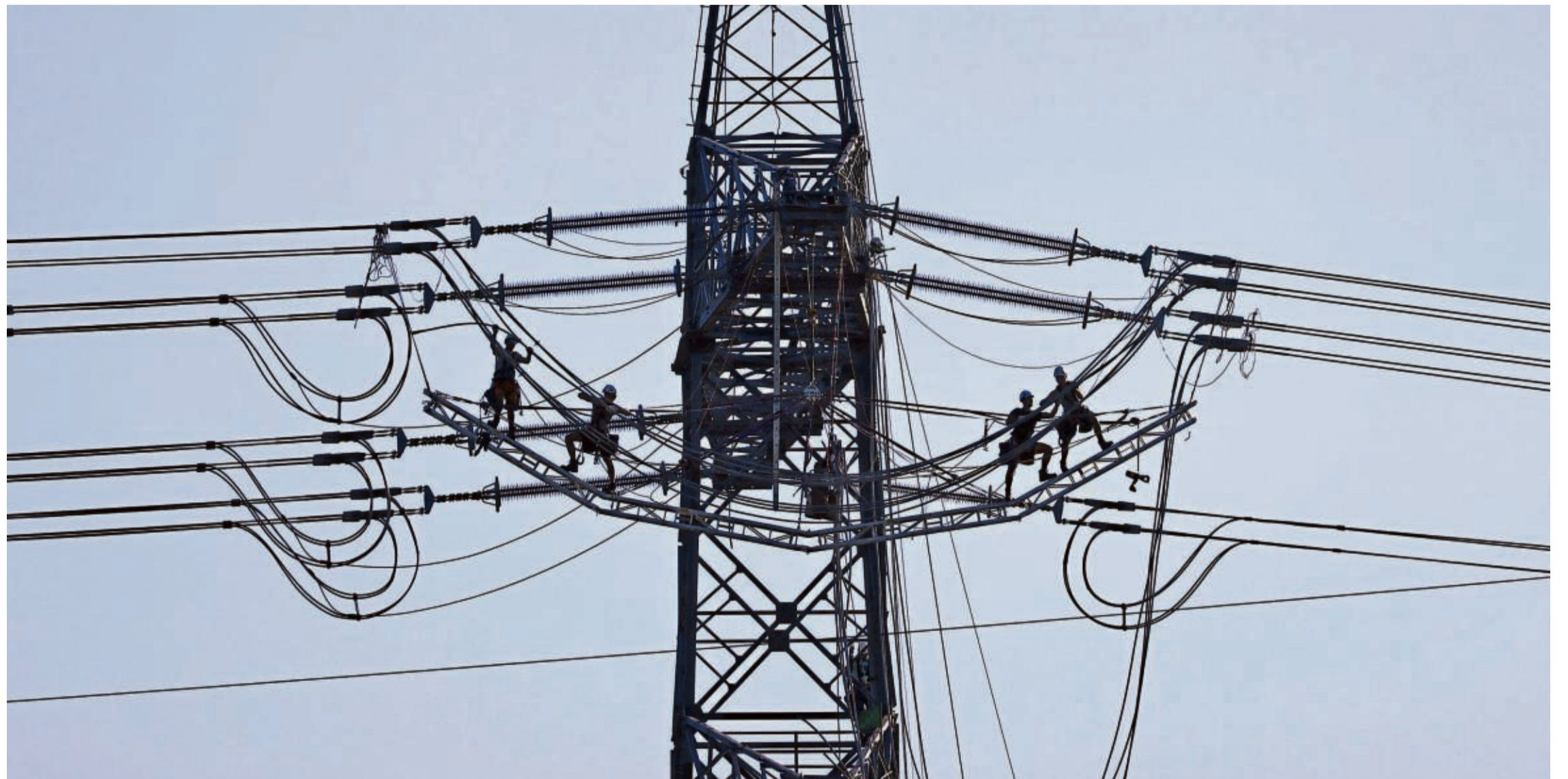
Der Gesetzentwurf der Bundesregierung sieht unter anderem die Beschleunigung der Planungs- und Genehmigungsverfahren für Höchstspannungsleitungen vor.
