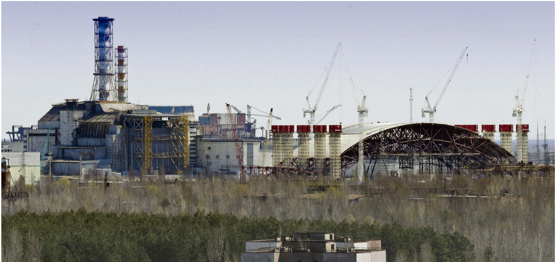
Das AKW in Tschernobyl im Jahr 2013. Auf der rechten Seite: Aufbau von der neuen Schutz-Hülle.
